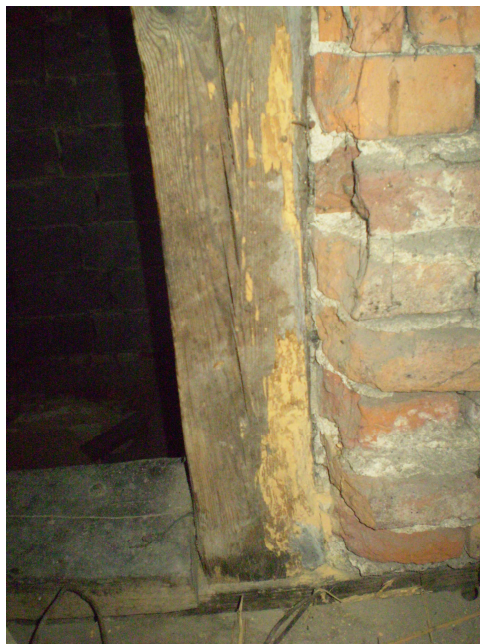
fot. 7 Widok na słup z korozją biologiczną
